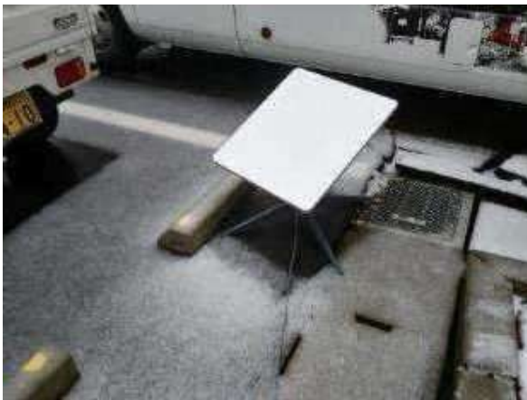
輪島市役所に設置したスターリンク
