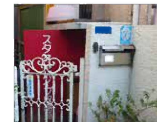
敷地内にあるスタンドパイプ収納箱
