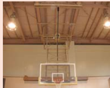
バスケットゴールに落下防止装置（中央たての黒い部分）を設置
